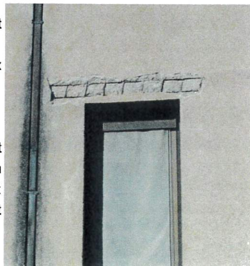
Vue d'un linteau béton au niveau 1 de la façade sud très dégradé, armature corrodées
