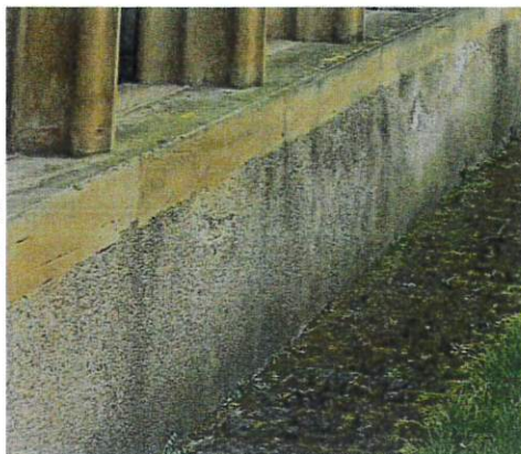
Vue de la façade nord de l'aile est : traces d'encrassement de l'enduit
