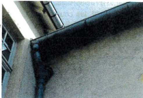
Vue de la descente d'eau pluviale déboîtée au nord est de l'aile est
