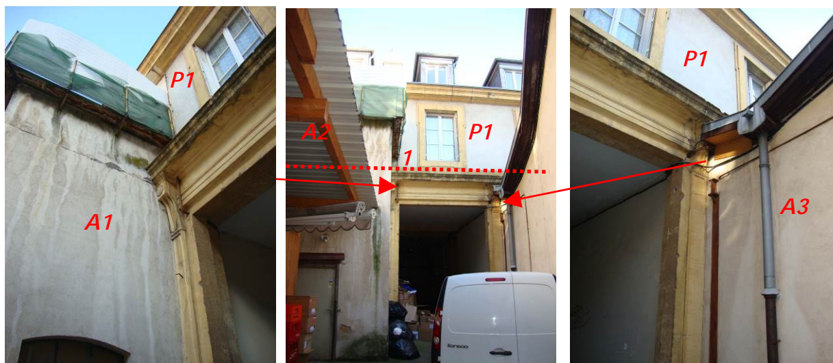
Cour C1 : l'emprise des annexes A1 et A3, empiétant sur l'encadrement du passage cocher côté rue Ambroise Thomas
