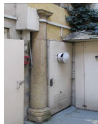
7-9, rue du Neufbourg. Colonne à chapiteau posée dans une cour après opération de rénovation. Elle se perd entre les réseaux et édifices techniques.
